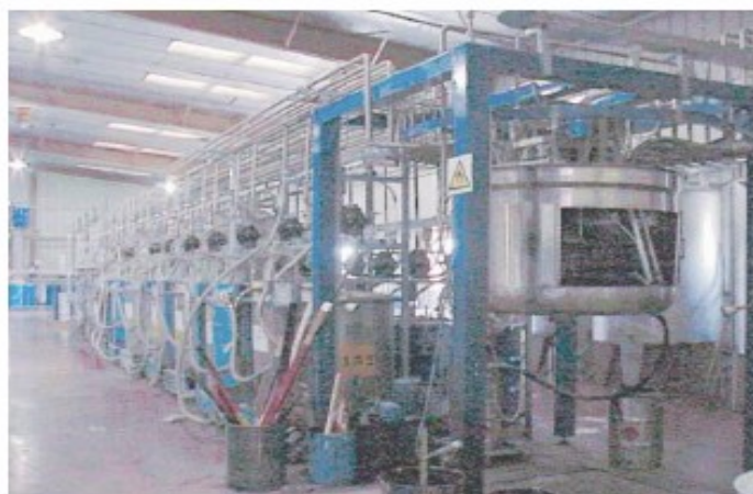
Photographie de l'installation
