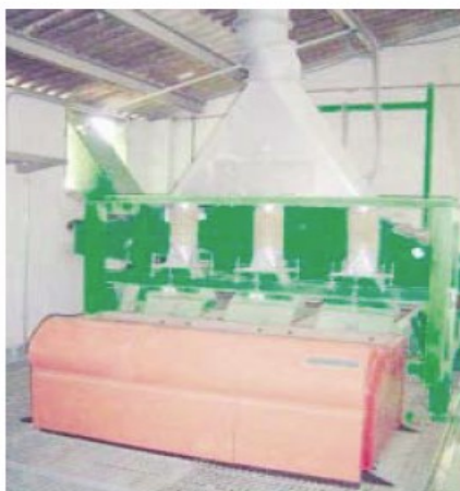
Machine permettant de trier le verre présent dans le déchet du recyclage du verre
