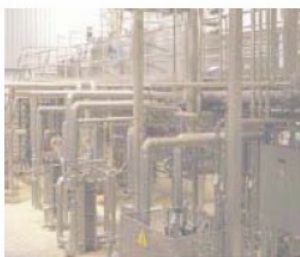
Réservoirs et tuyauterie à nettoyer
