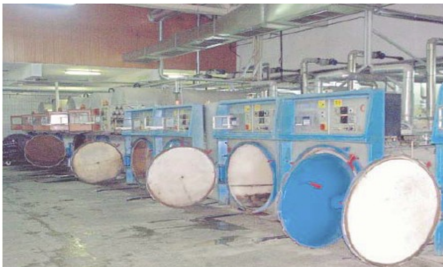
Batterie du pasteurisateurs
